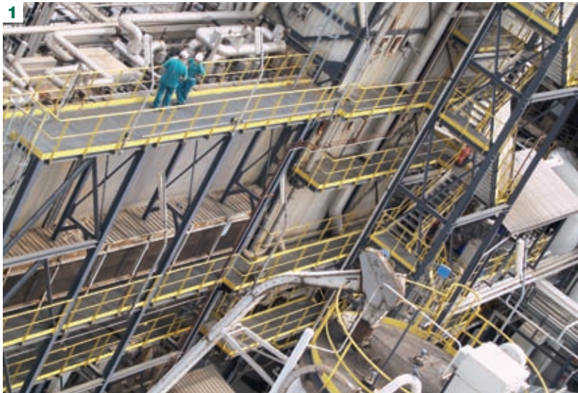
1 - Impianto per il trattamento dei rifiuti urbani e speciali
