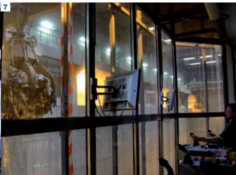
7 - Cabina di controllo
