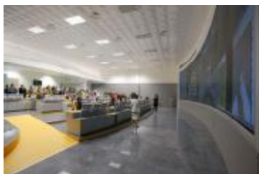
Il telecontrollo della rete di Forlì
