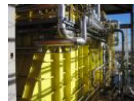
CCGT di Rimini particolare della caldaia
