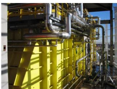
Particolare dell'impianto CCGT di Imola
