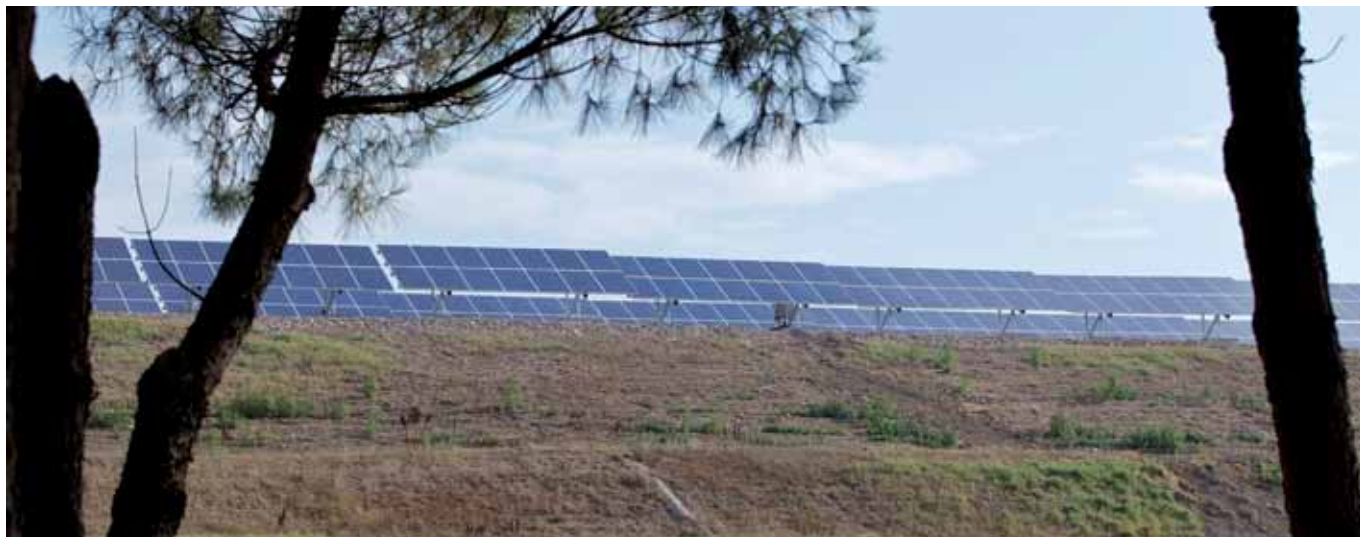
Impianto fotovoltaico realizzato da Coop Sole Ravenna S.C.C. sulla discarica Herambiente di Ravenna, al km 3,8 della SS 309 Romea (Ravenna) Photovoltaic plant implemented by Coop Sole Ravenna S.C.C. on Herambiente Ravenna landfill, km 3.8 Romea State Highway (Ravenna)
