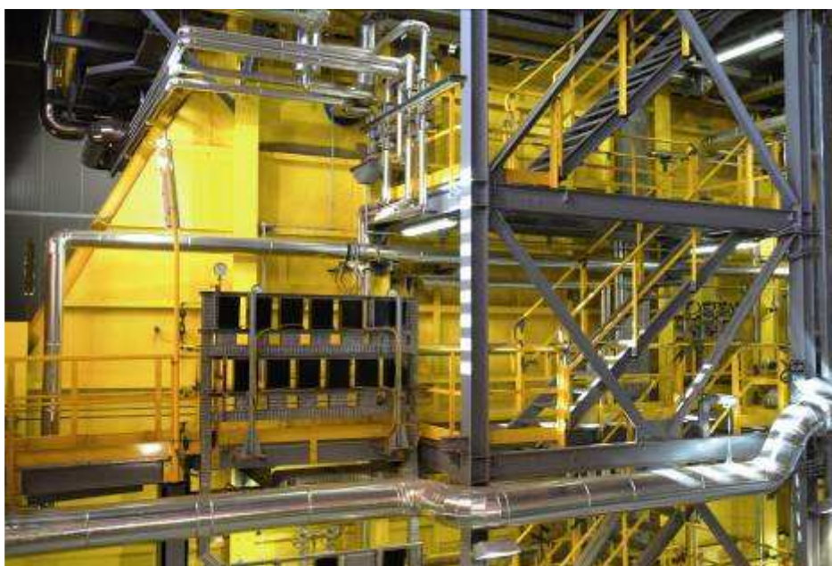
Fig. 8 Vista su una delle due caldaie a recupero
