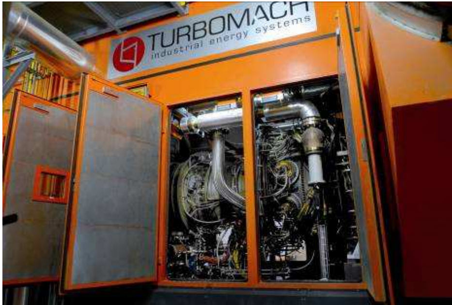
Fig. 7 Particolare di una delle due turbine a gas
