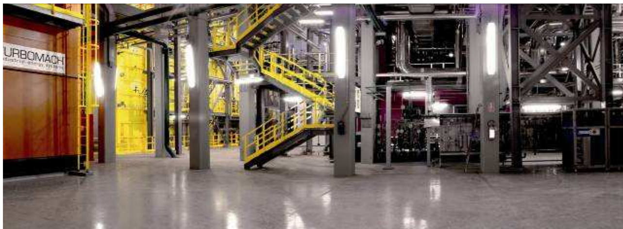
Fig. 10 Vista sulla sala macchine della Centrale di Cogenerazione
