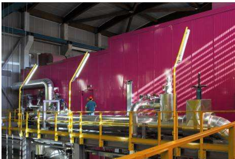
Fig. 9 Vista sulla turbina a vapore
