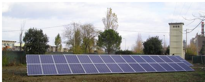
Figura 26 Vista lato Sud-Ovest dell'impianto fotovoltaico
